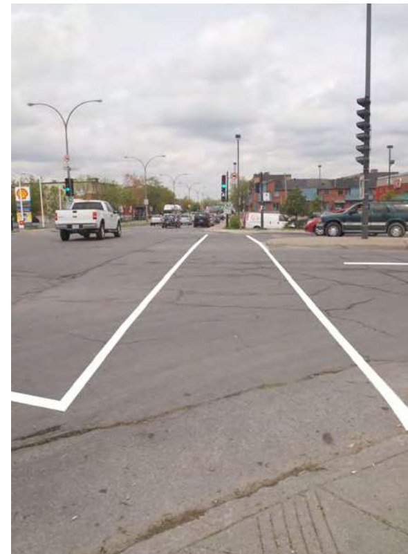
Photo 2c : Terre-plein trop près du passage pour piétons, risque important d'être rencontré
