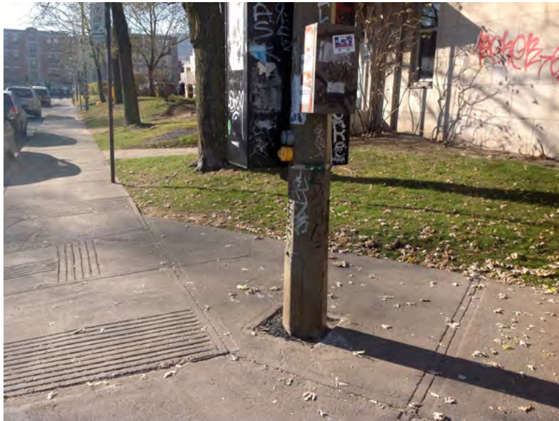
Photo 1a : Caisson en saillie non détectable par la canne blanche
