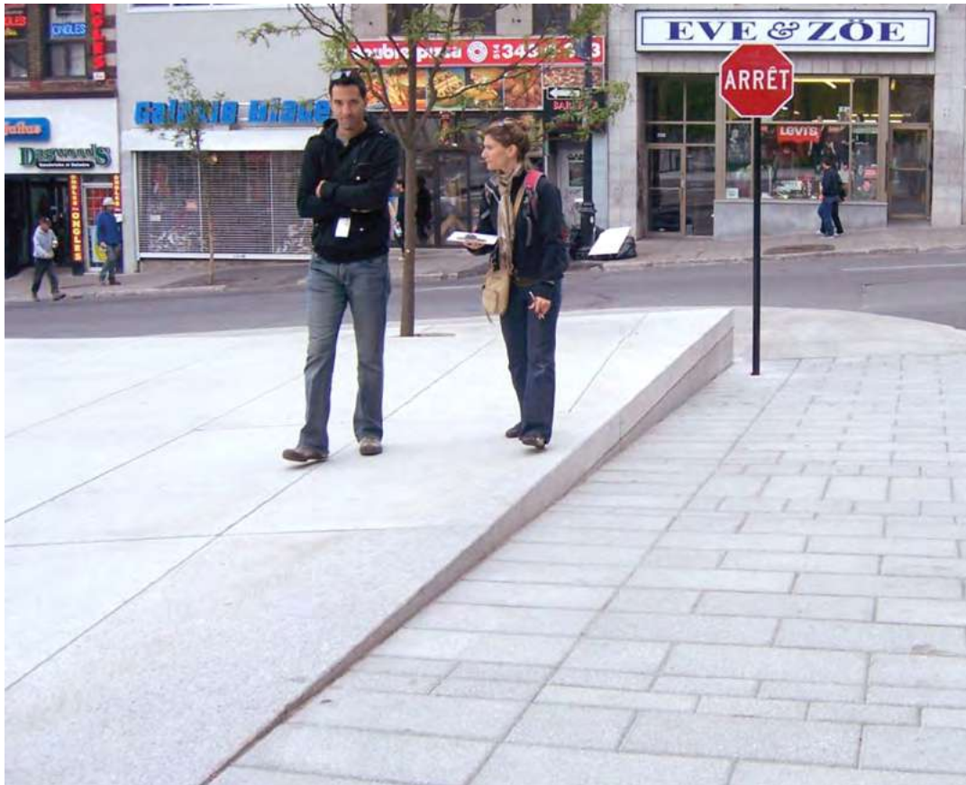
Photo 6 : Dénivellation non protégée par un garde-corps
